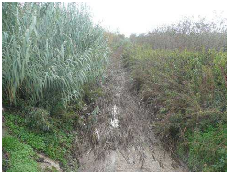
Figura 118. Lagno di Quindici. Vista verso monte in corrispondenza della confluenza con l'Alveo Camaldoli. La sezione si presenta arginata e con materiale vegetale in alveo.
