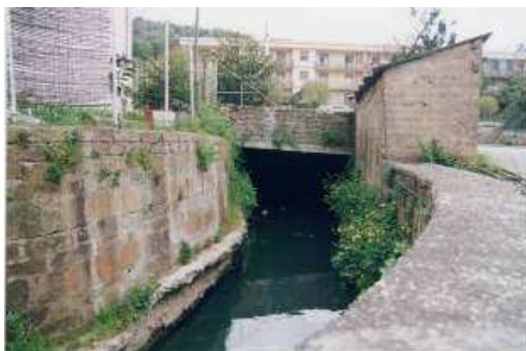
Figura 192. Lagno di Arpaia (Bacino del Carmignano). Vista verso monte del tratto situato in prossimità del centro abitato di San felice a Canello (Fonte AdBNO – 2001).
