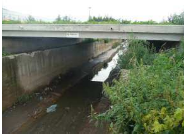
Figura 155. Lagno di Avella. Visto verso monte del tratto situato all'interno della zona industriale. Il tratto fotografato presenta una sezione regolare e costante ed è rivestito in calcestruzzo. Non è presente materiale depositato né la presenza di vegetazione in alveo. In primo piano è visibile un manufatto in calcestruzzo prefabbricato, tale struttura si ripresenta all'incirca ogni 150 m di sviluppo dell'alveo per tutto il tratto compreso all'interno della zona industriale, la sua utilità è sconosciuta, si ipotizza che abbia funzione puramente estetica per la presenza di giardini pensili. La sua presenza non influisce sul deflusso dell'acqua.
