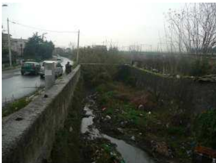
Figura 177. Lagno di Sorbo. Vista verso valle del tratto in prossimità del cimitero.
