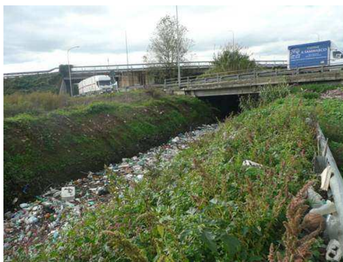
Figura 138. Lagno di Quindici. Vista verso valle in prossimità dell'attraversamento dell'autostrada A16. E' visibile materiale di rifiuto depositato sul fondo.
