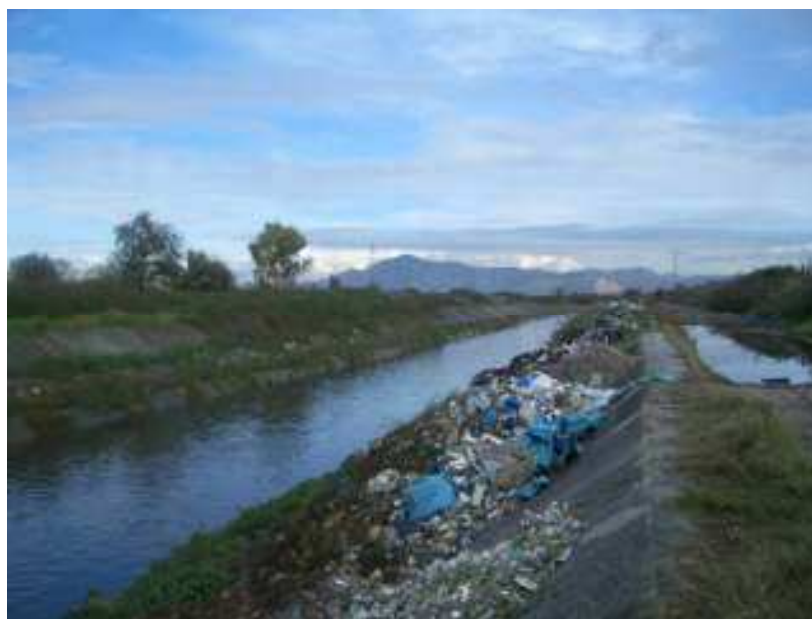
Figura 110. Canale dei Regi Lagni all'altezza del fuggatore Cuparella, materiale di rifiuto depositato lungo l'argine.
