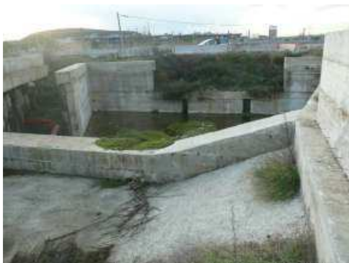
Figura 149. Lagno di Gaudio. Vista verso valle in prossimità del raccordo stradale della zona industriale nominata CIS. Sullo sfondo a sinistra si intravede il nuovo centro commerciale "Vulcano buono". La foto riprende un manufatto in calcestruzzo realizzato alcuni anni fa e mai entrato in funzione, posizionato sul percorso del lagno. La funzione di tale manufatto non è chiara, è stato ipotizzato che serva per laminare il Lagno di Gaudio. Attualmente il lagno viene deviato a sinistra di tale manufatto. Da osservare che le quote di tale manufatto non sono coerenti con le quote del fondo del lagno.
