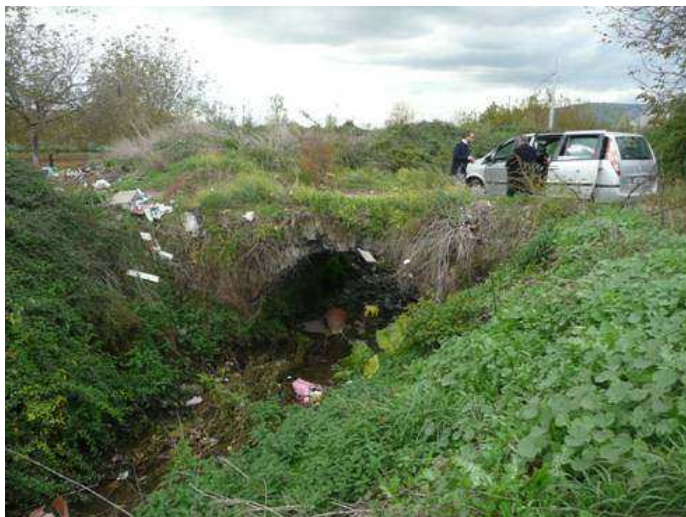
Figura 139. Lagno di Quindici. Vista verso valle in prossimità del Ponte delle Tavole. In quest'ultimo tratto l'alveo è ostruito da fitta vegetazione.
