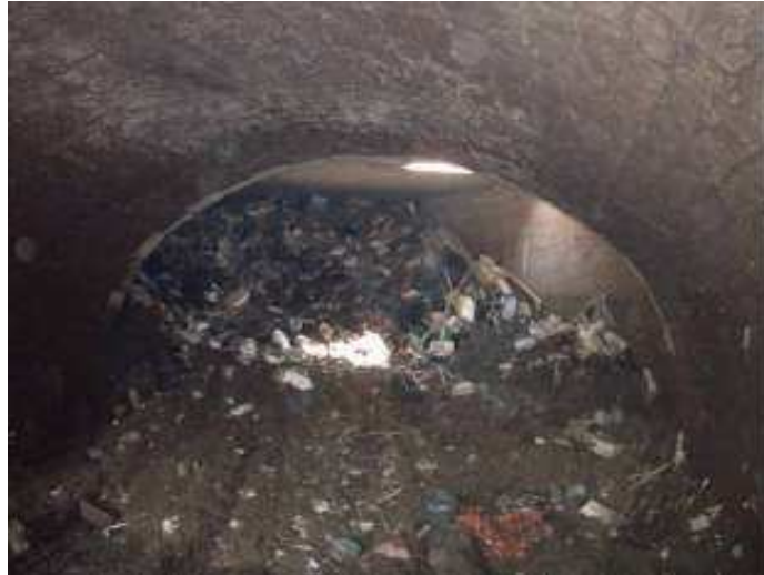
Figura 127. Lagno di Quindici. Vista dell'interno del tratto tombinato presente nel centro dell'abitato di Nola. La figura mostra l'intasamento causato dal materiale trasportato, prima dell'intervento di pulizia eseguito nel 2008. (Gentile concessione del Dott. Del Gaudio – 2008)
