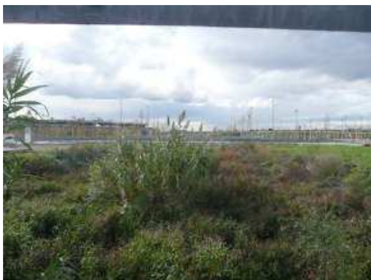
Figura 151. Lagno di Gaudo. Tratto a valle del manufatto visto nella foto precedente. La sezione è stata rifatta durante i lavori di realizzazione del centro commerciale “Vulcano buono”. Il fondo è stato rivestito con materassi Reno mentre le sponde sono state realizzate con gabbionate. La sezione attualmente si presenta invasa da vegetazione.
