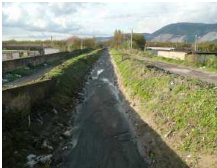
Figura 145. Lagno di Gaudio. Visto verso valle dal ponte della frazione di San Donato. In tale tratto si può notare come la sezione rimanga regolare ed è interessato da deposito dovuto a trasporto solido di fondo. Tale tratto è pensile.
