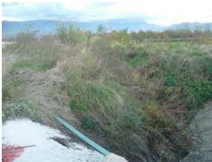
Figura 150. Lagno di Gaudo. Vista verso monte del tratto deviato adiacente del manufatto visto nella foto precedente. Da notare la sezione ristretta e completamente invasa dalla vegetazione.
