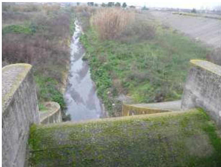
Figura 176. Lagno di Spirito Santo. Vista verso monte della vasca Guadagno. In primo piano è visibile il manufatto in cemento per la regolazione delle portate.
