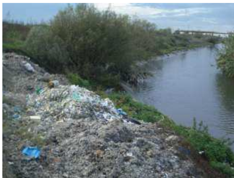
Figura 111. Canale dei Regi Lagni, materiale di rifiuto depositato lungo l'argine e ammaloramento del rivestimento in calcestruzzo.
