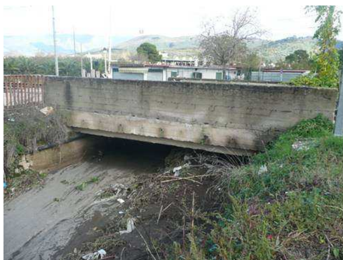
Figura 123. Lagno di Quindici. Vista verso monte. Tratto a nord del cimitero di Nola. E' visibile il parapetto del ponte della strada di accesso al cimitero. Si nota come anche in questo caso il materiale depositato sia di grandi quantità, la luce del ponte è quasi per metà ostruita dal materiale depositato.
