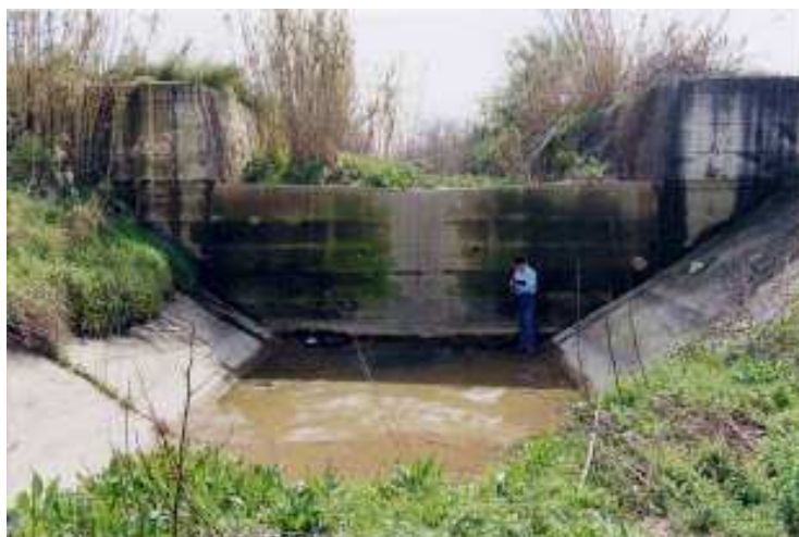
Figura 152. Lagno di Gaudo. Visto verso monte della soglia posizionata alla confluenza con il canale dei Regi Lagni (Fonte AdBNO – 2001).
