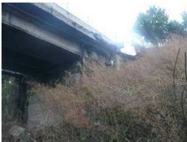
Figura 167. Lago di Leone. Ponte di Via Circumvallazione. È visibile un accentuato ammaloramento del ponte, in particolare il distacco di parte del piano di calpestio del marciapiede.
