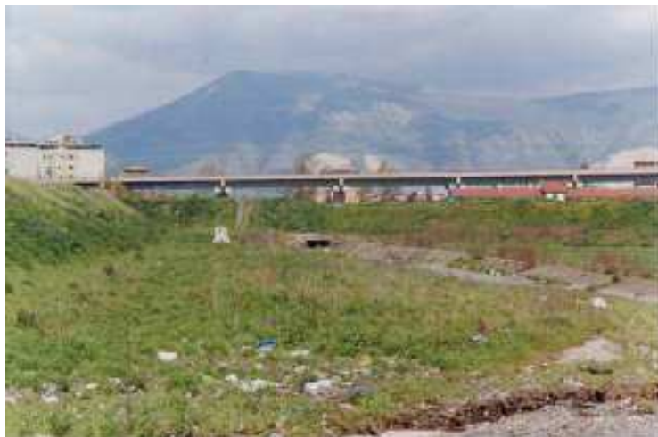
Figura 165. Lago di Somma. Vista verso valle della vasca di Marigliano situata a sud del centro abitato di Marigliano. Al centro della fotografia è visibile il manufatto di regolazione delle portate situato all'imbocco del tratto tombinato che attraversa il centro abitato (Fonte AdBNO – 2001).
