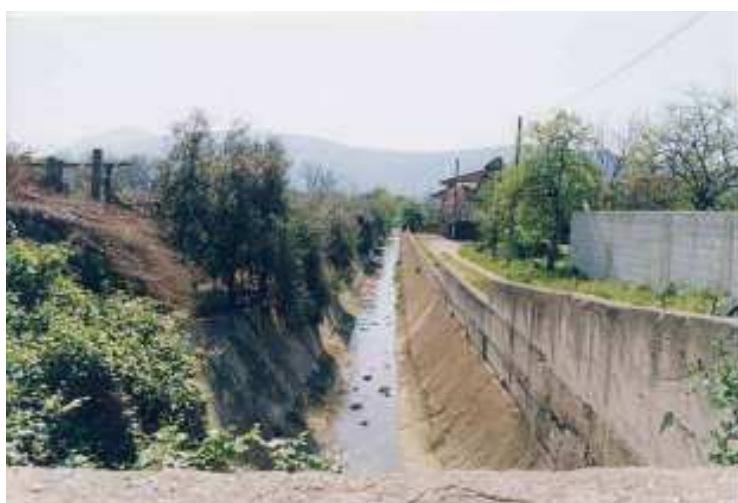
Figura 189. Canale del Carmignano (Bacino del Carmignano). Vista verso monte del tratto situato in prossimità della frazione di Masseria Grande (Fonte AdBNO – 2001).
