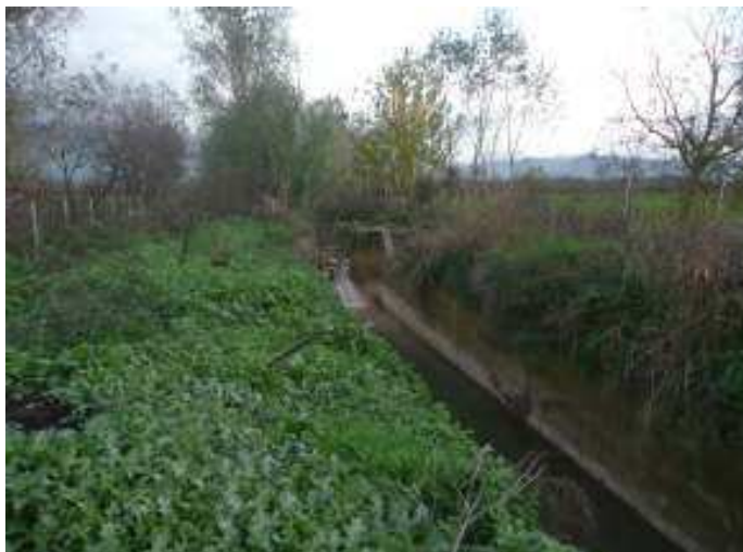
Figura 157. Lagno di Avella. Vista verso monte in prossimità della Masseria Ruggente. La sezione come nelle foto precedenti si mantiene costante e regolare ed è pulita da sedimenti e vegetazione. Al centro è visibile il manufatto del modulatore in ottimo stato ma non più funzionante a causa dell'interramento del canale scolmatore situato in destra orografica (nella foto non è visibile perché completamente interrato e coperto di vegetazione; nella foto si troverebbe a sinistra)
